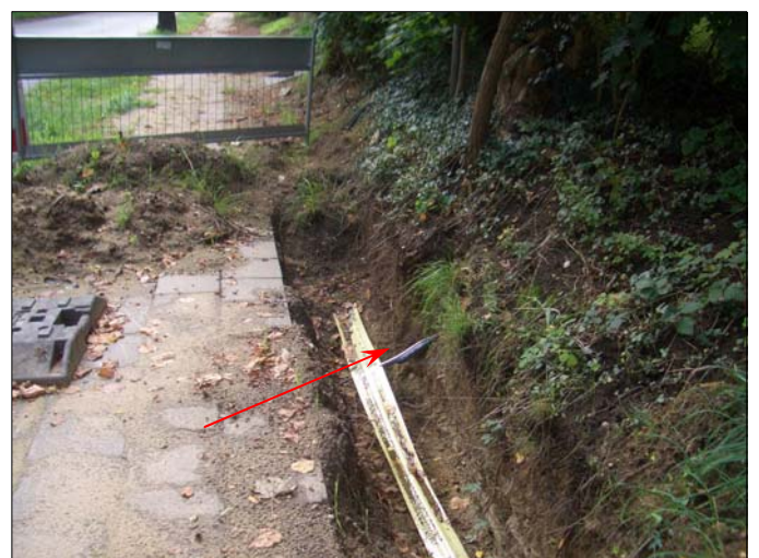
Hausanschlusskabel neben einem Baum entlang der alten Stromtrasse
